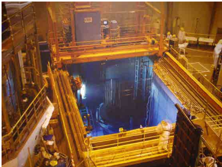
Figura 6: La vasca del reattore della centrale di Gravelines durante le operazioni di ricarica del combustibile: il nocciolo è accessibile con la copertura del recipiente in pressione aperta e la gru di sollevamento in uso. L'acqua garantisce il raffreddamento e la schermatura delle radiazioni durante tutta l'operazione. Il caratteristico colore blu è causato dall'effetto Cherenkov: le particelle radioattive emesse dal combustibile viaggiano nell'acqua a una velocità superiore a quella della luce nel medesimo mezzo, generando una radiazione luminosa di colore blu.
