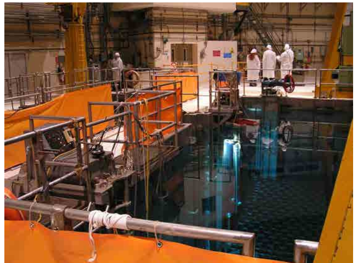
Figura 7: Esempio di vasca di stoccaggio del combustibile esausto della centrale nucleare di Caorso (Italia). I Fuel Assembly esauriti sono conservati immersi nell'acqua, visibili sul fondo attraverso il caratteristico bagliore bluastro causato dall'effetto Cherenkov. L'acqua raffredda il combustibile e scherma le radiazioni, mentre la radioattività decade progressivamente nel tempo.
